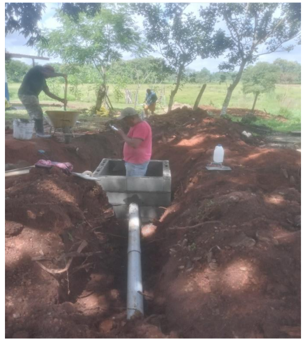
Cámara de inspección
